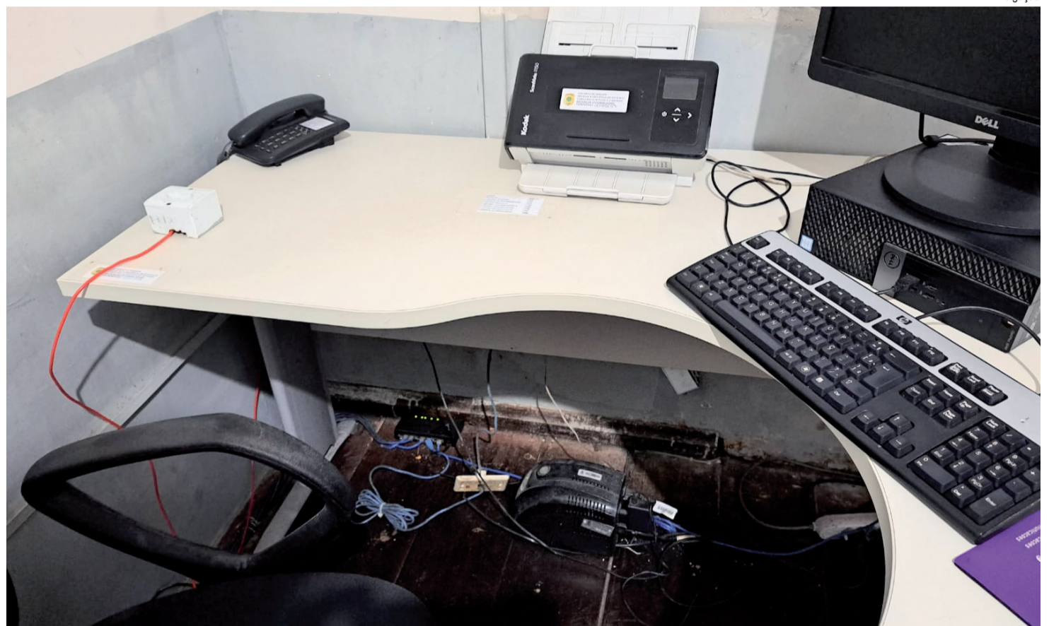
FIAÇÃO EXPOSTA NA SALA DA CHEFIA DA DELEGACIA DE ESTÂNCIA: SINPOL DIZ QUE FALTA DE ESTRUTURA ATINGE TODAS AS PLANTONISTAS DA CAPITAL E DO INTERIOR
