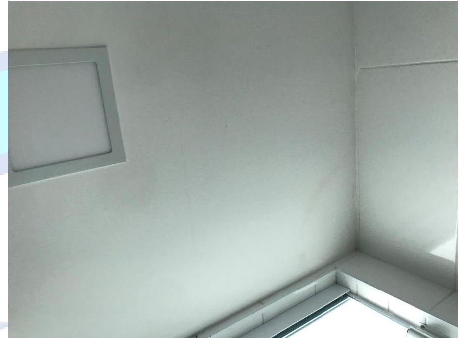
Foto 2 – Mancha de infiltração/umidade banheiro masculino na área do auditório.
