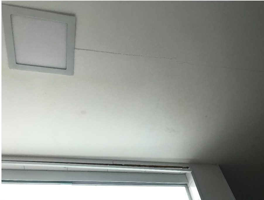
Foto 3 – Trincas no forro de gesso do banheiro feminino da área do auditório e perfil de alumínio solto no acabamento do revestimento.
