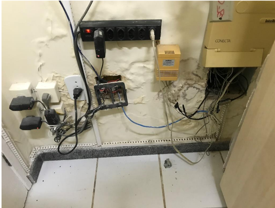
Foto 15 – Surgimento de mancha de umidade no entorno das instalações.
