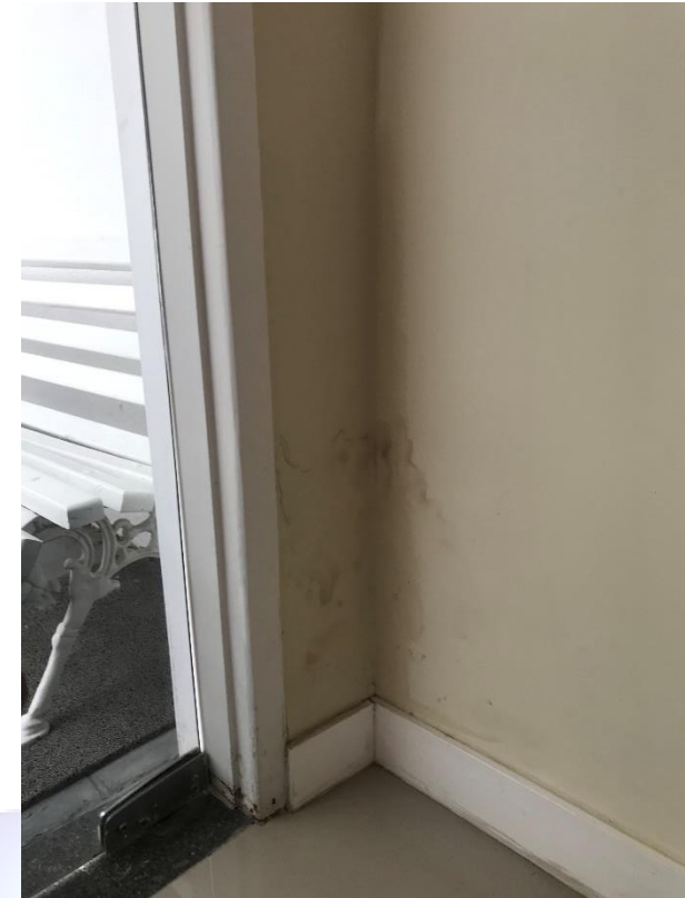
Foto 14 – Surgimento de mancha de umidade no entorno da porta de acesso ao auditório.
