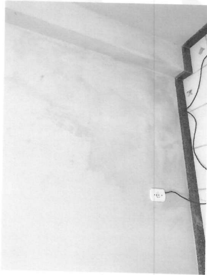
Foto 23 – Manchas de infiltração na sala de contabilidade.
