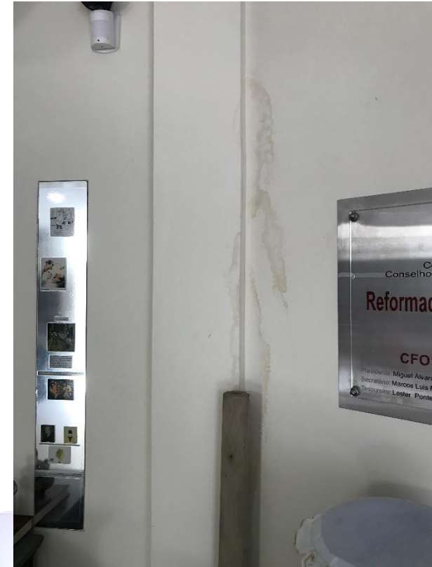
Foto 16 – Surgimento de mancha de umidade proximo a placa de inauguração.
