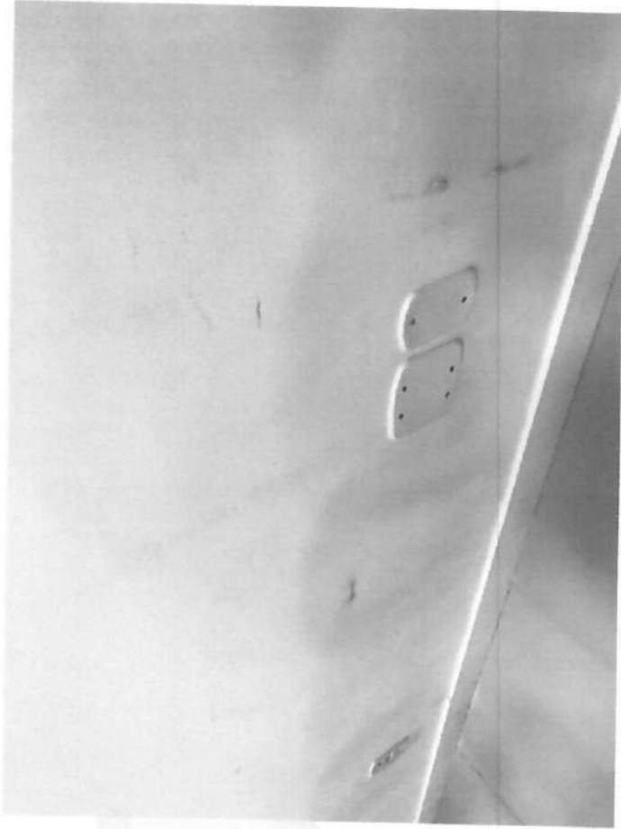
Foto 26 – Manchas de infiltração no auditório.
