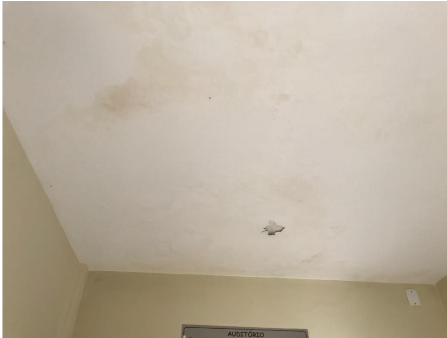
Foto 13 – Surgimento de mancha de umidade na laje do hall de entrada do auditório.
