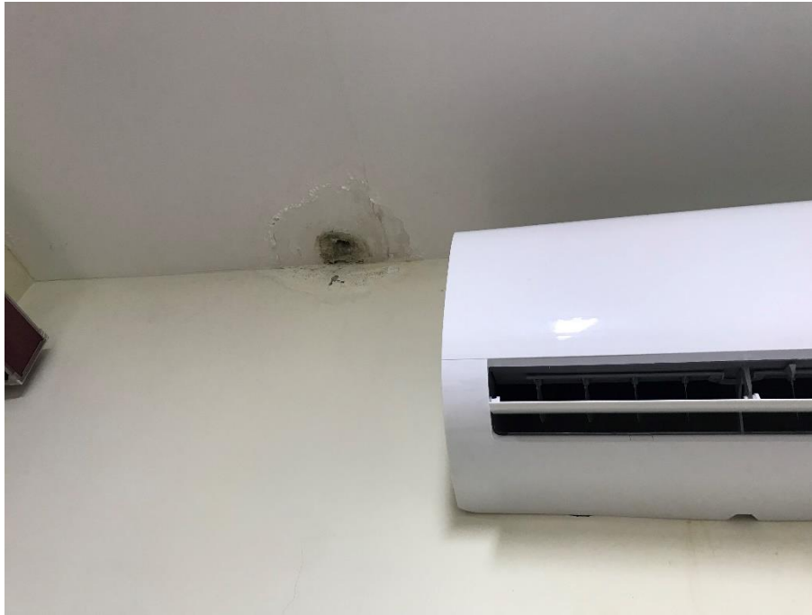
Foto 25 – Surgimento de aberturas no forro de gesso na sala da fiscalização.
