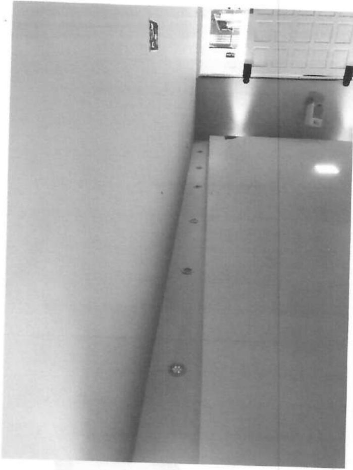
Foto 12 – Falha na luminária tipo “olho de boi”.
