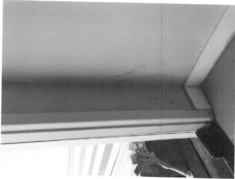
Foto 14 – Surgimento de mancha de umidade no entorno da porta de acesso ao auditório.
