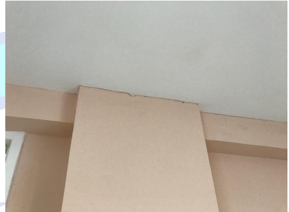
Foto 8 – Trincas no forro de gesso na área de eventos (denominação do projeto).
