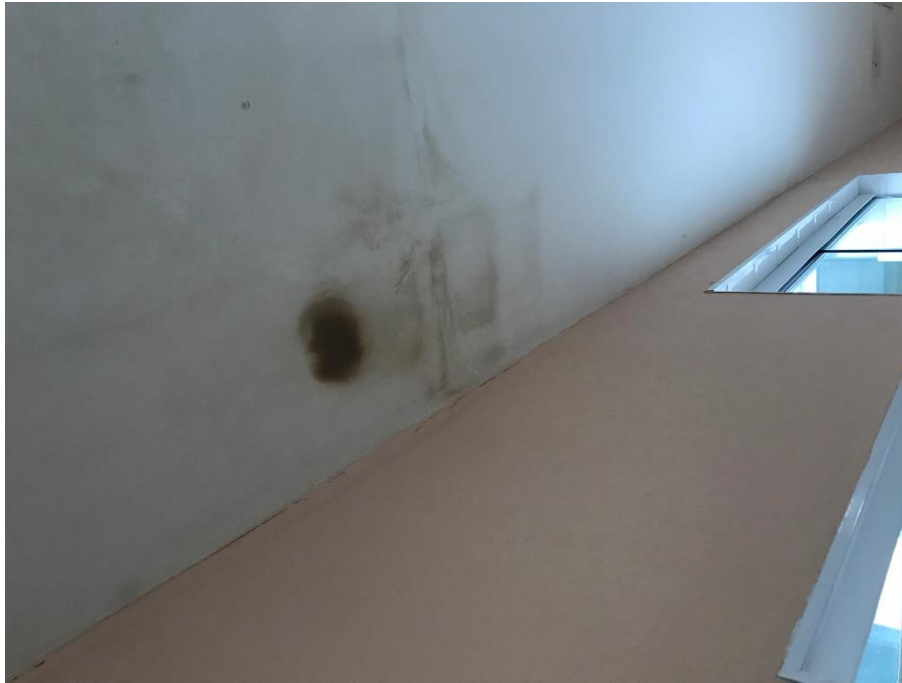
Foto 5 – Surgimento de mancha de umidade no forro de gesso na área de eventos (denominação do projeto).
