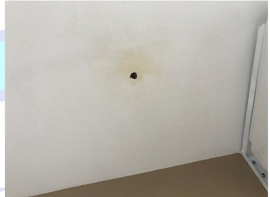
Foto 4 – Surgimento de aberturas no forro de gesso na área de eventos (denominação do projeto).
