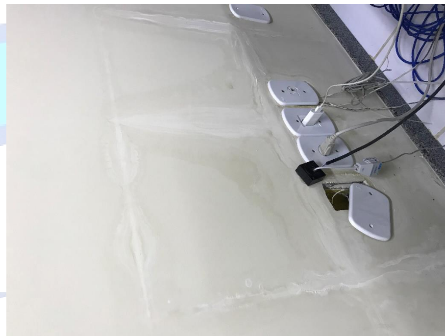
Foto 24 – Manchas de infiltração na sala da fiscalização.
