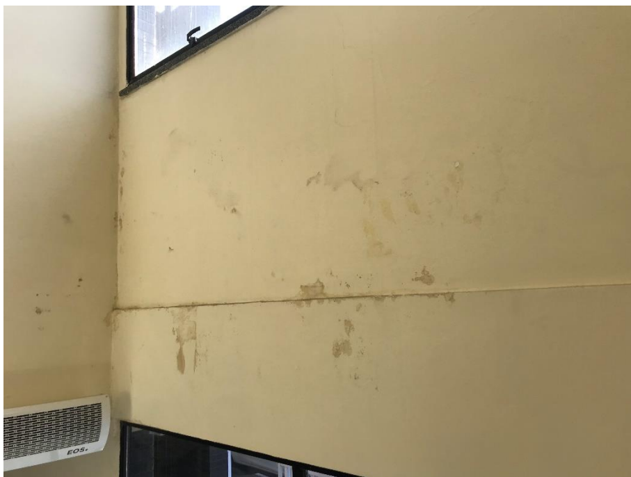
Foto 17 – Surgimento de mancha de umidade próximo a esquadrias da fachada.
