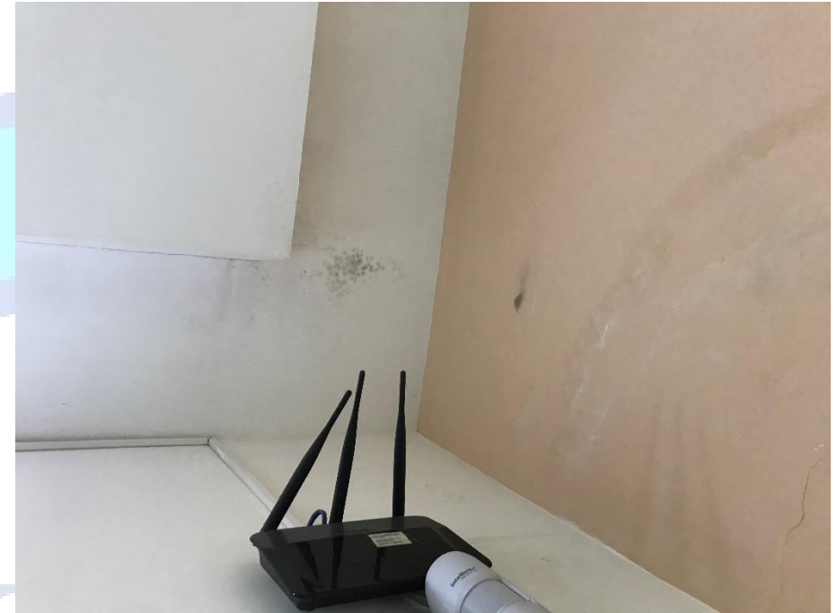
Foto 10 – Surgimento de mancha de umidade no forro de gesso na área do auditório.
