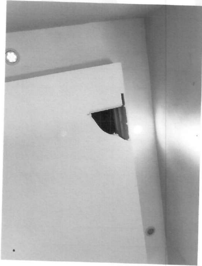
Foto 11 – Surgimento de abertura no forro de gesso.
