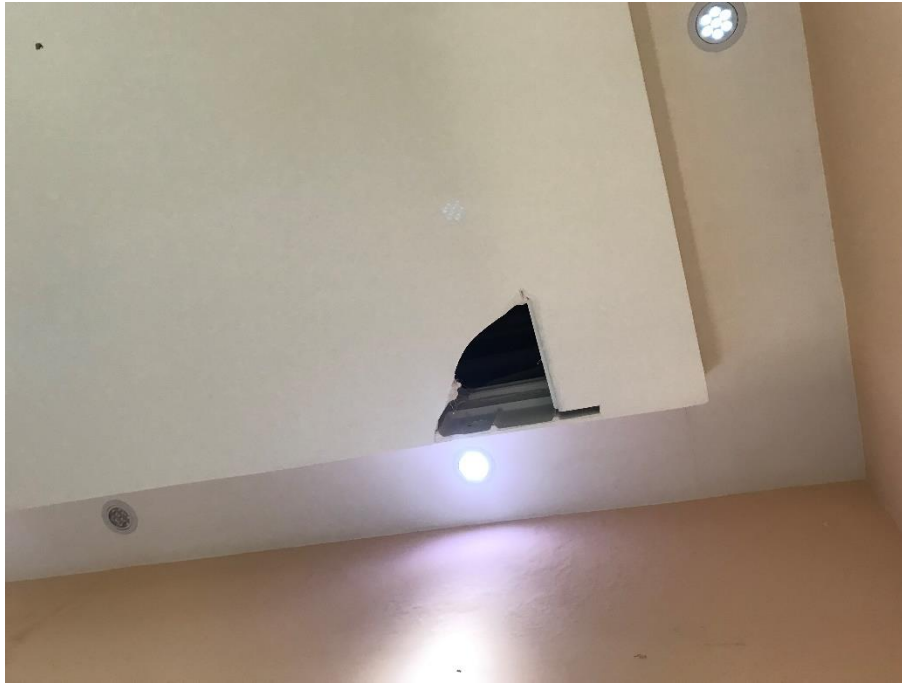
Foto 11 – Surgimento de abertura no forro de gesso.
