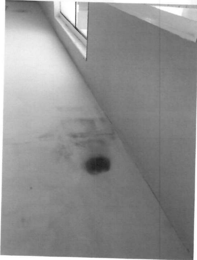
Foto 5 – Surgimento de mancha de umidade no forro de gesso na área de eventos (denominação do projeto).
