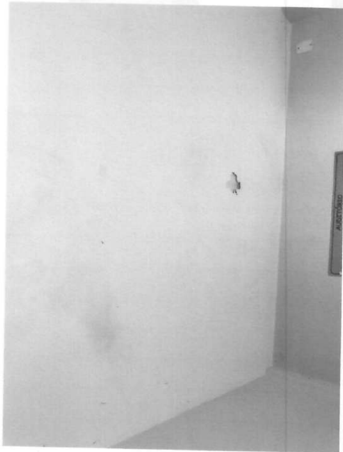
Foto 13 – Surgimento de mancha de umidade na laje do hall de entrada do auditório.
