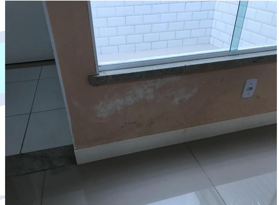
Foto 6 – Surgimento de mancha de umidade no entorno das esquadrias das áreas de ventilação.
