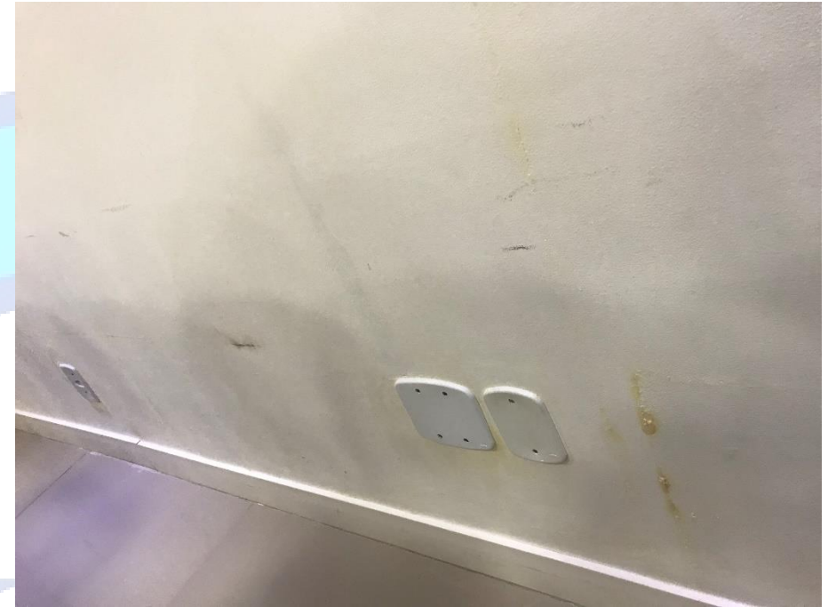
Foto 26 – Manchas de infiltração no auditório.
