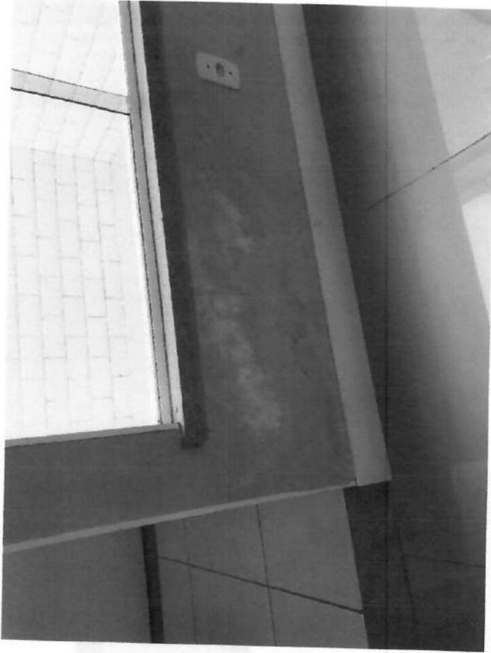
Foto 6 – Surgimento de mancha de umidade no entorno das esquadrias das áreas de ventilação.
