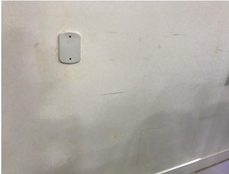
Foto 1 – Mancha de infiltração no auditório.
