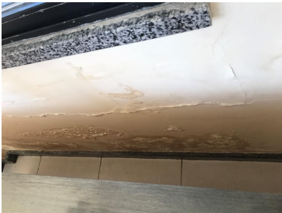
Foto 19 – Surgimento de mancha de umidade na esquadrias da sala do presidente.
